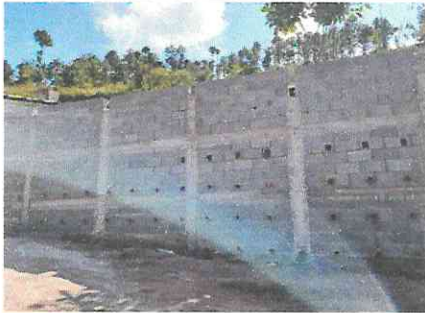
Foto 1: Se observa que la parte de enfrente cerca de los sanitarios el muro perimetral fue sustituido en su totalidad por muro de block y no se observa posibles ingresos no deseados.
