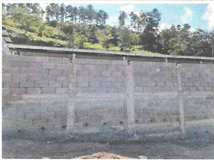
Foto 3: se evidencia nuevamente que el muro perimetral en la parte de enfrente fue sustituido en su totalidad por pared de block, dejando tubos plásticos en cuenta la humedad del terreno.
